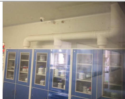
理化室试剂柜通风橱
