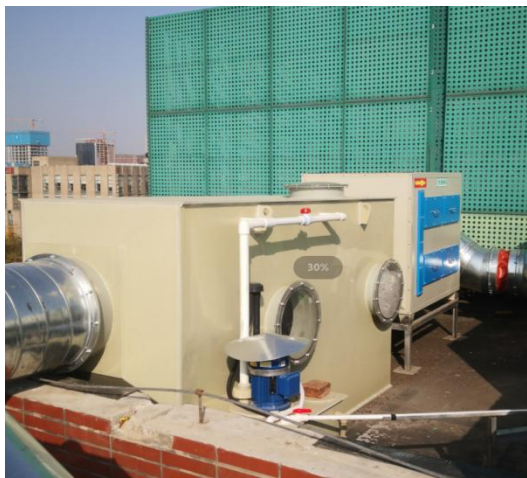
碱性喷淋塔+活性炭吸附装置
