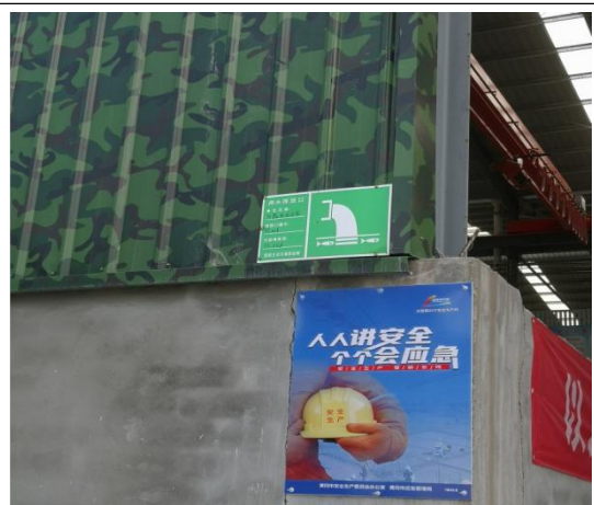
雨水排放口标识牌
