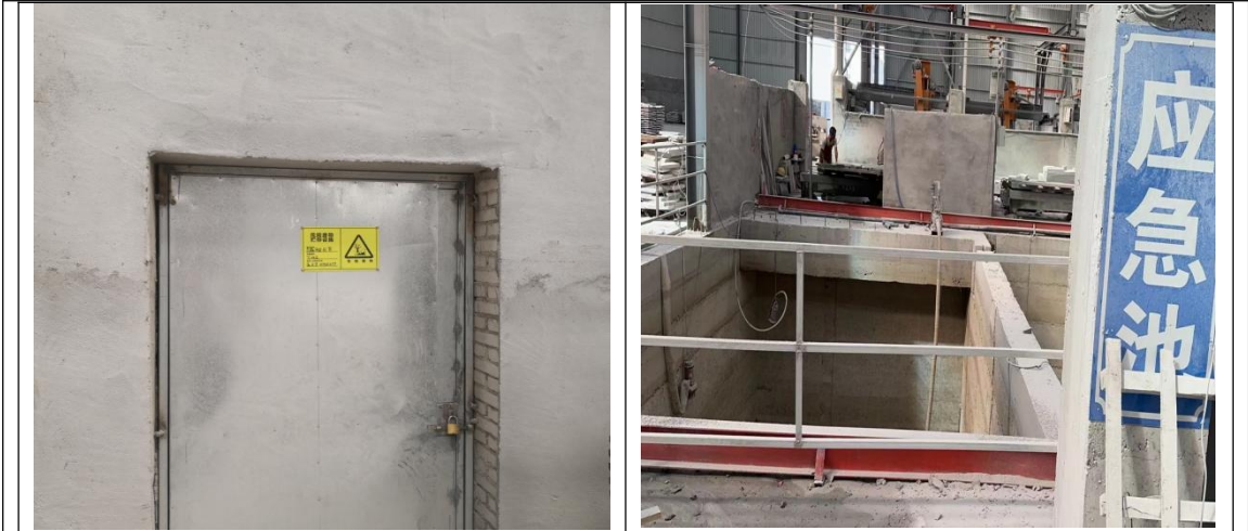
危险废物暂存间
